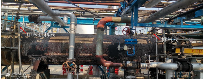
某企业烯烃厂丁二烯装置“10·28”火灾事故
